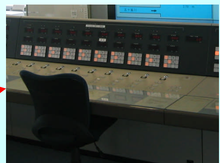
ゲート操作卓 (ゲートの開閉操作を行います)
