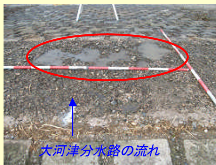
固定堰天端部の表面の摩耗状況
