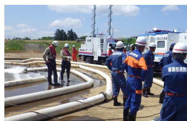
排水ポンプ車訓練
