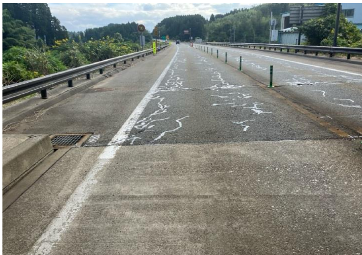
舗装の損傷状況
