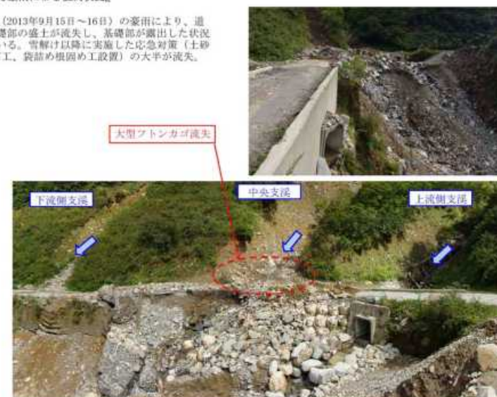
被災状況概観(2013.9.27撮影)
