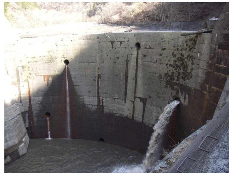
濁水発生状況
